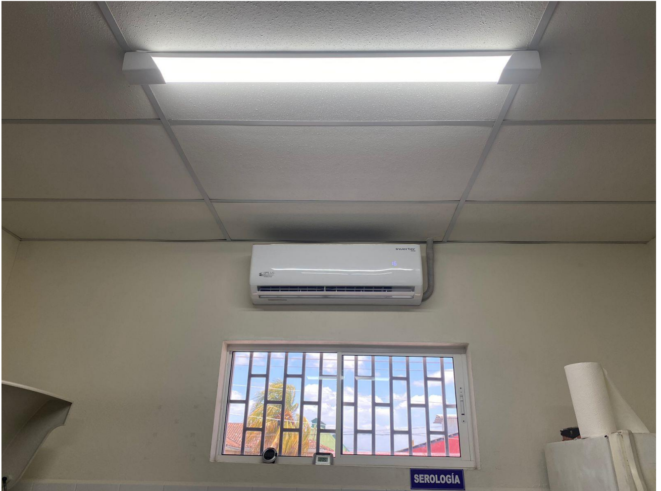
Climatización del laboratorio clínico. Fuente: Imagen de elaboración propia
