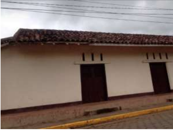
Foto 21. aprovechamiento solar y ventilación
