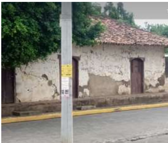
Foto 13. Ejemplo de pared inadecuada.
