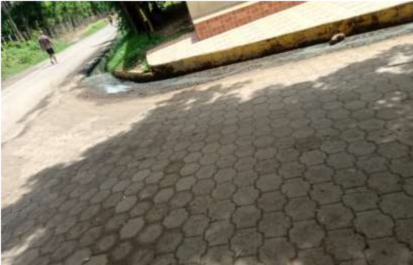
Foto 8. Cunetas en mal uso. Aguas servidas empozadas.
