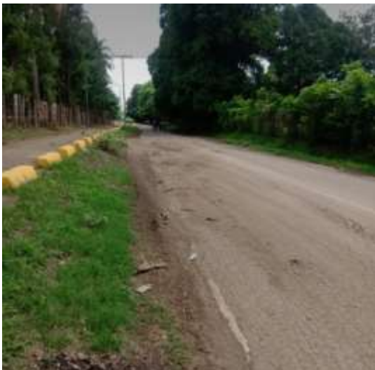
Foto 7. Calles en mal estado
