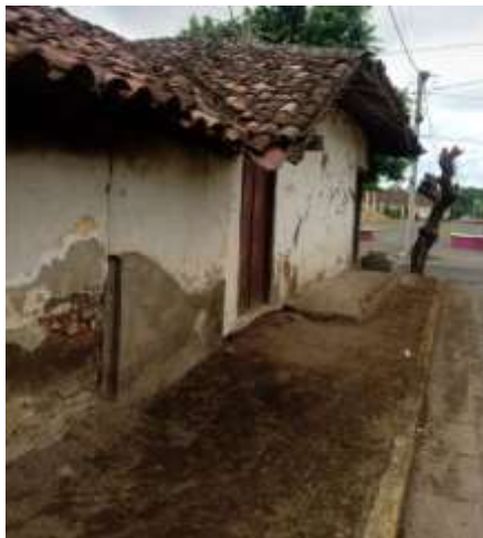
Foto 23. Amenaza por sismo e inundación. Pared y techo inadecuado
