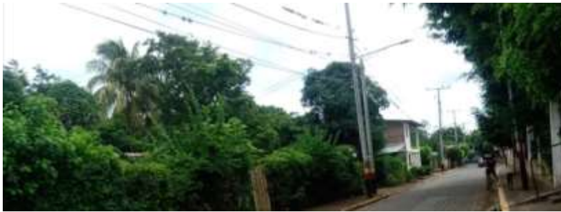
Foto 9. Cables de distribución eléctrica.
