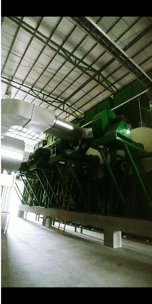
Figura 4 Vista lateral del horno de fuego directo
