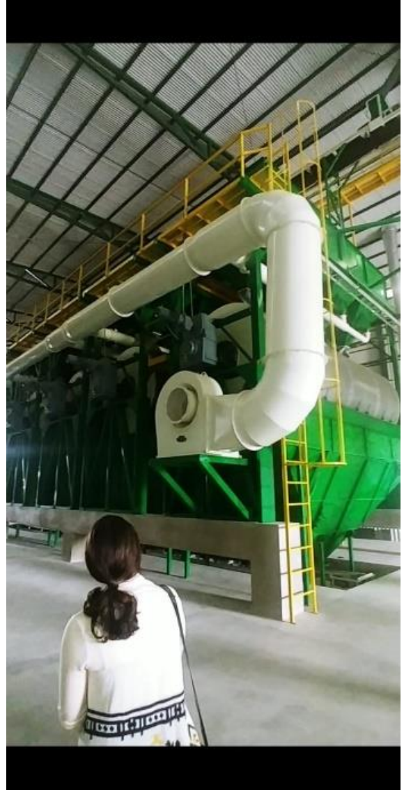
Figura 7 Vista lateral del horno de fuego directo
