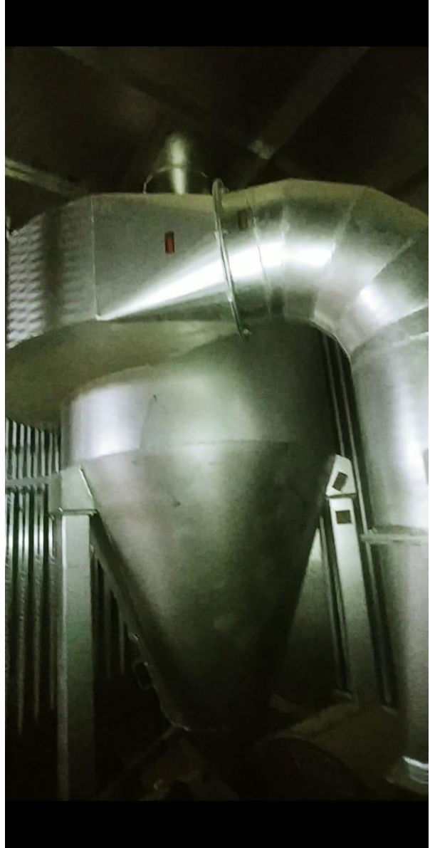
Figura 5 Ducto de inyección de calor del horno
