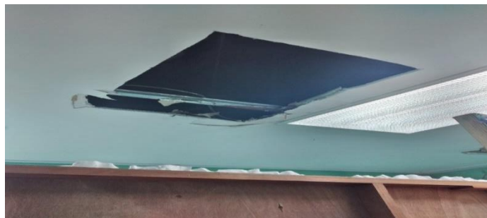
Ilustración 33. Techo en mal estado Editorial Universitaria
