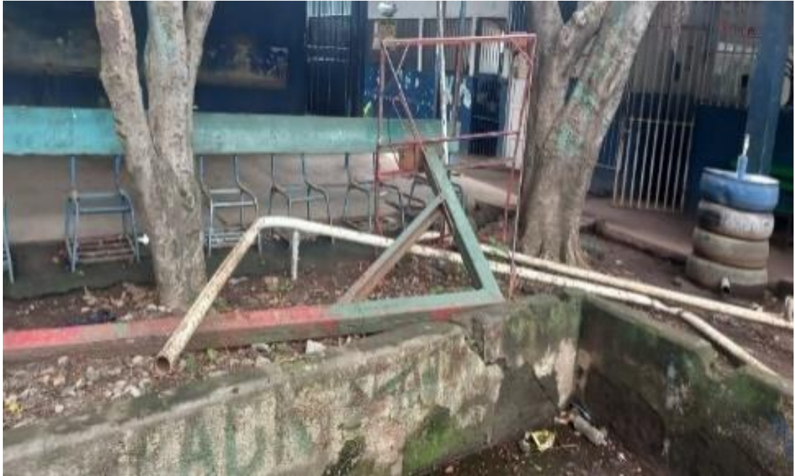
Ilustración 4 Cancha de básquet destruida
