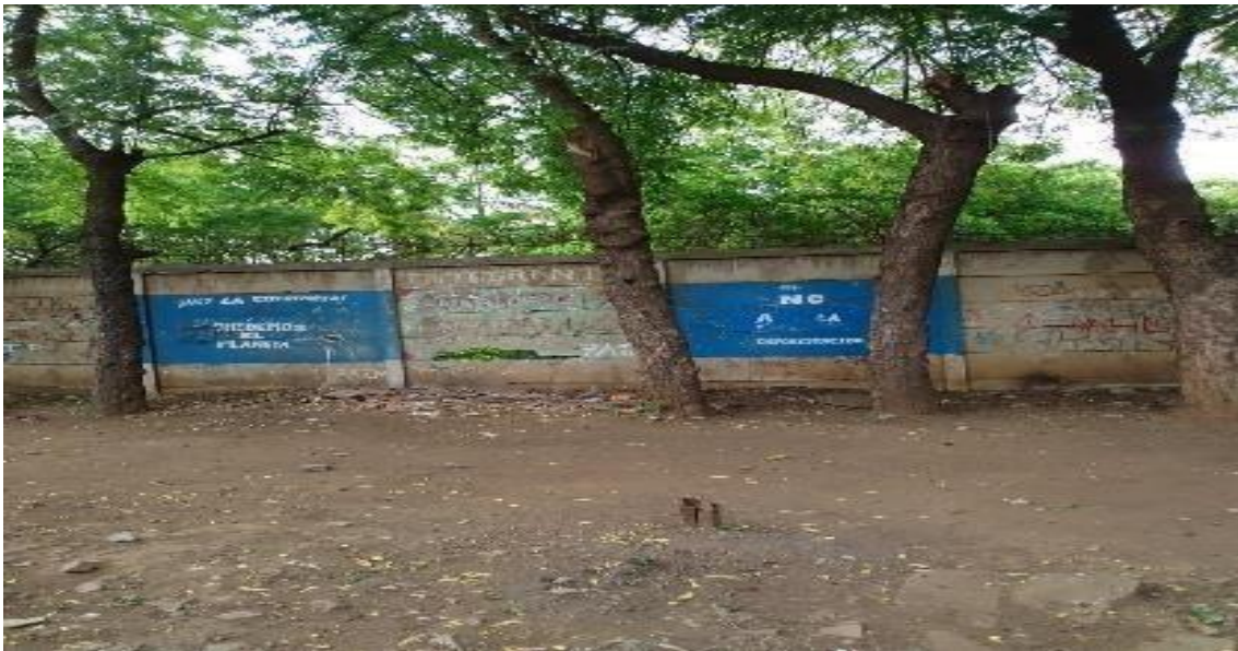
Ilustración 9 Muro perimetral en mal estado
