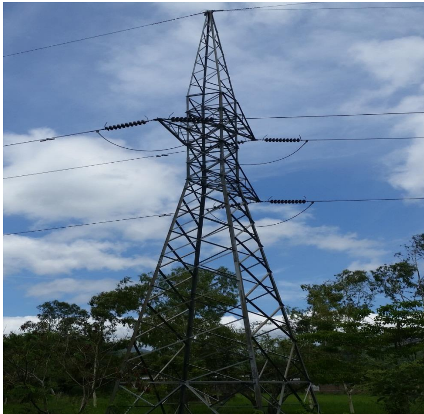
Ilustración 4, ANTENA CON ALTO VOLTAJE EN INSTALACIONES DE FAREM.
