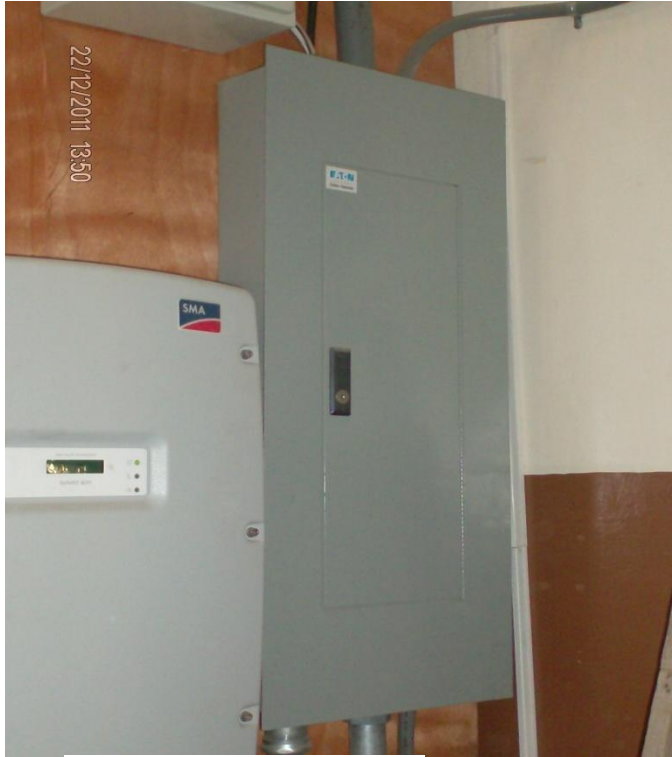
A1 Panel de distribución
