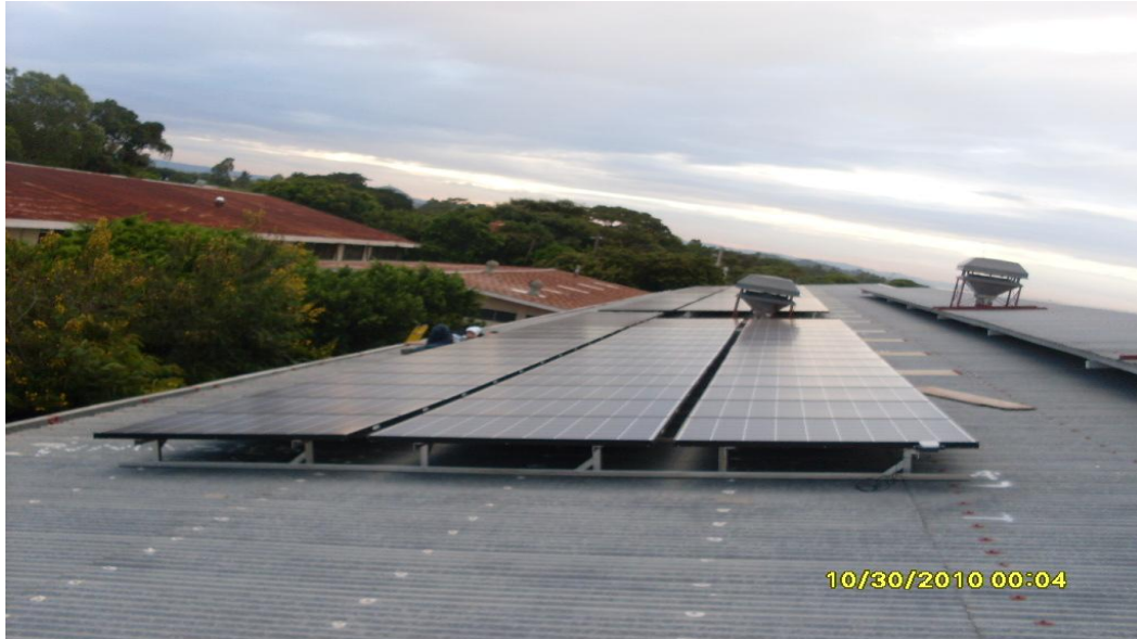
Fig.10 Arreglo de los paneles fotovoltaicos. Crédito: M. Sc. Ing. Aracely Hernández Méndez
