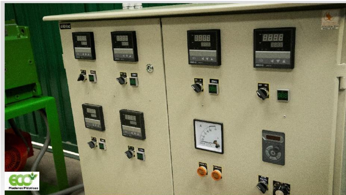
Foto 16 - Panel de control de máquina extrusora
