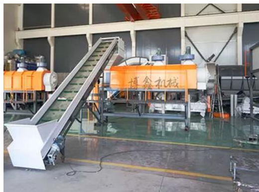
Foto 9 - Cinta transportadora y removedor de etiqueta
