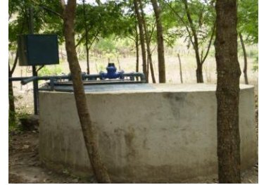
Ilustración 53 Pozo de suministro de Agua
