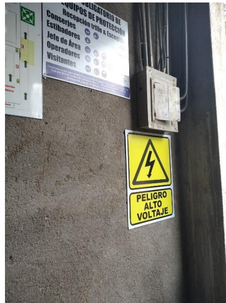
Figura. 2 señalización de peligros
