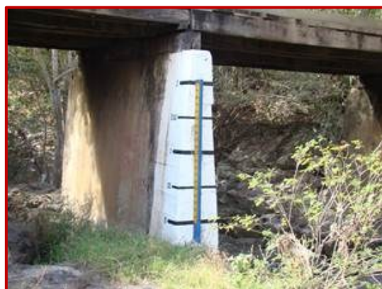
Medidor del nivel de caudal en el puente de La Estanzuela.
