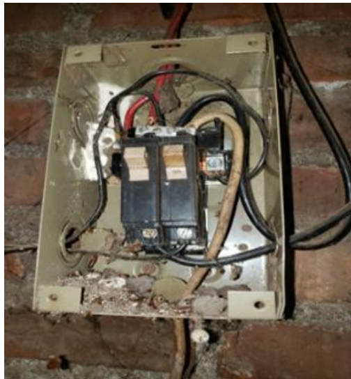
Figura 8: Estado del panel eléctrico de dos breaker del panel eléctrico de un breaker
