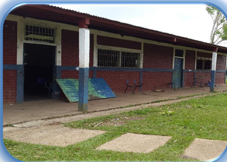
Figura 3. Destrucción de la planta física del centro.
