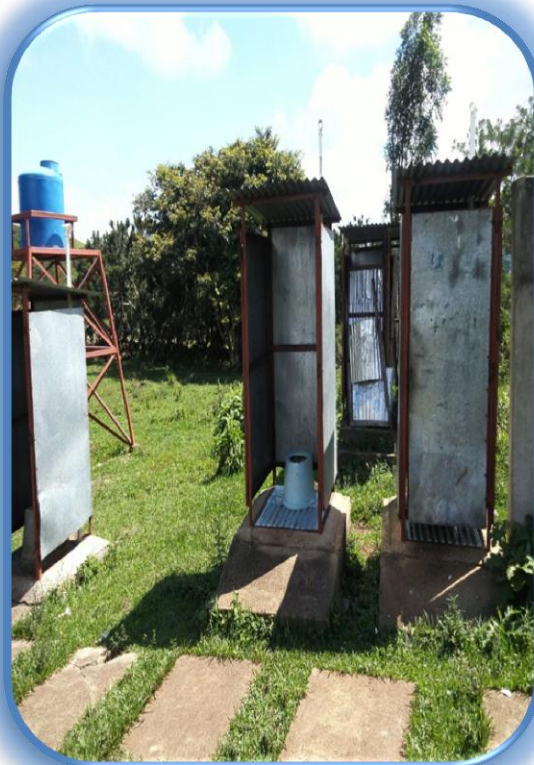
Figura 2. Destrucción y robo de servicios.
