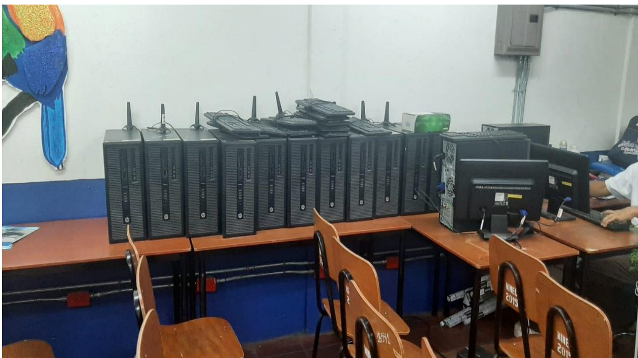
Equipos del Aula TIC.
