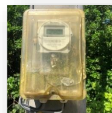
31. Imagen del medidor de energía Fuente: Google
