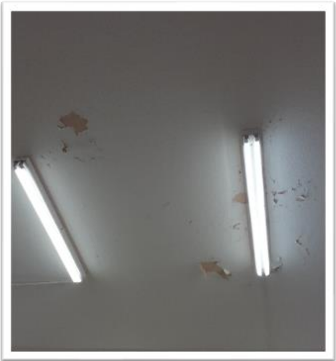
Fuente: Claudia Granera Muñoz – Cristina Hernández Suazo Desprendimiento de pintura en el techo de salas de lectura y depósitos, 2019
