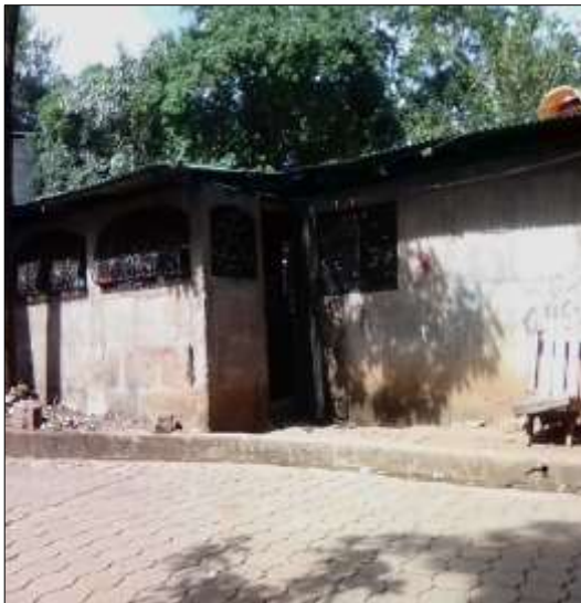
Fotografía IV-3. Vivienda mal construida.
