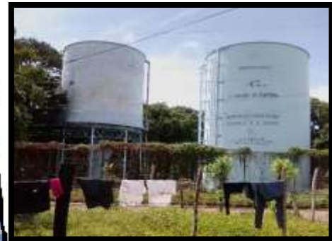
Fotografía-2: Tanques de agua potable.
