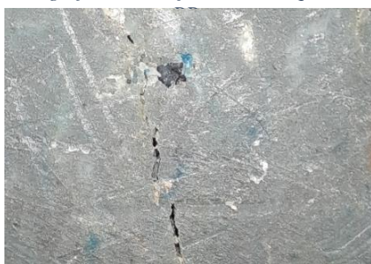
Fotografía VIII-15, fisuras en bloques de
