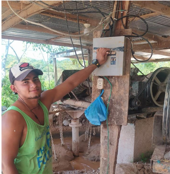
Imagen 12.1.8 Encendido de motor manualmente.
