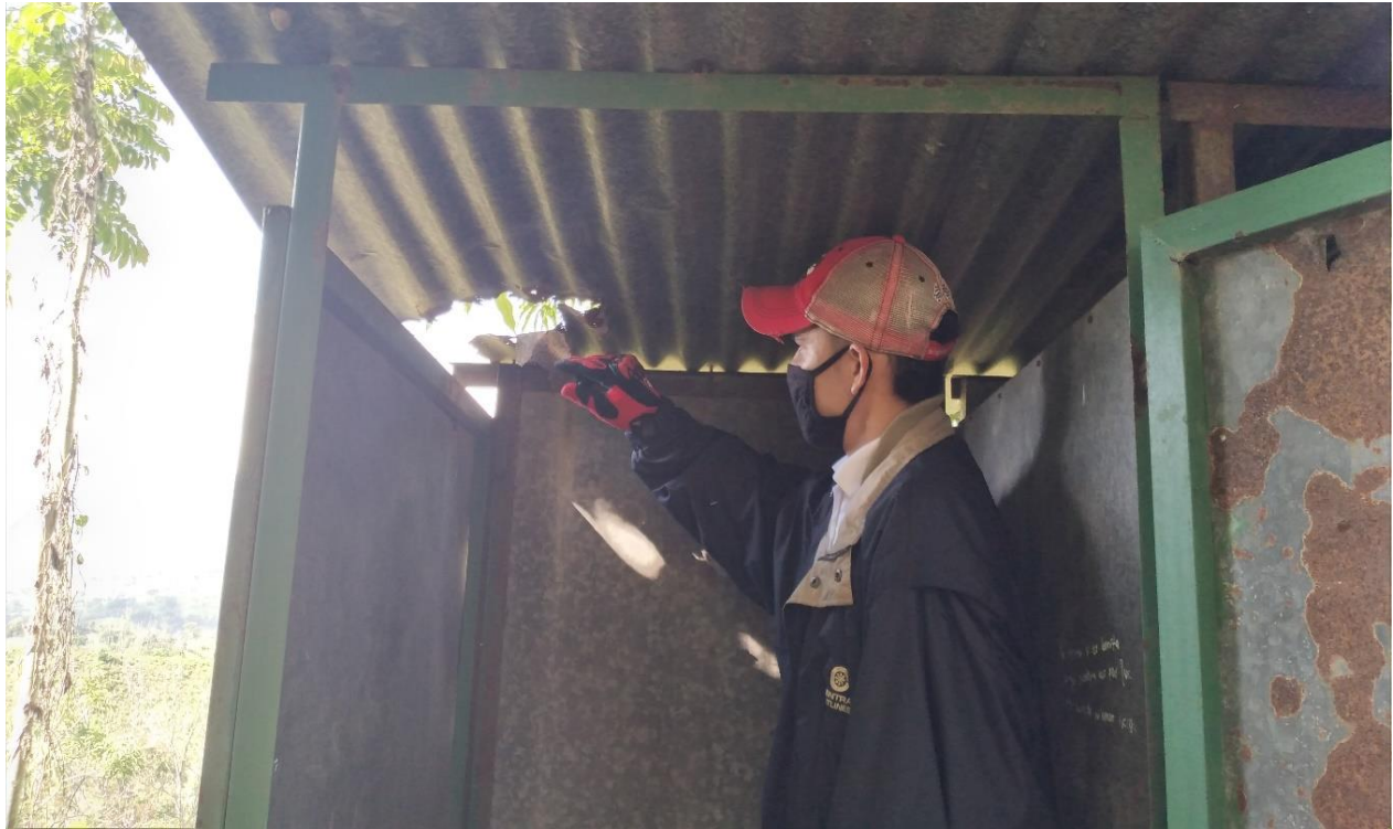
Anexo 2. Daños del servicio sanitario actual. (Elaboración propia)
