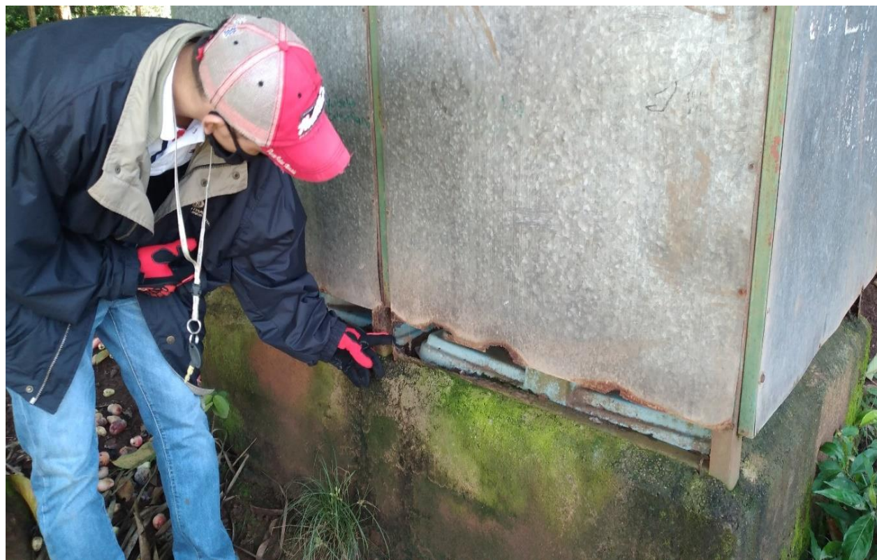
Anexo 1. Sanitario actual. (Elaboración propia)
