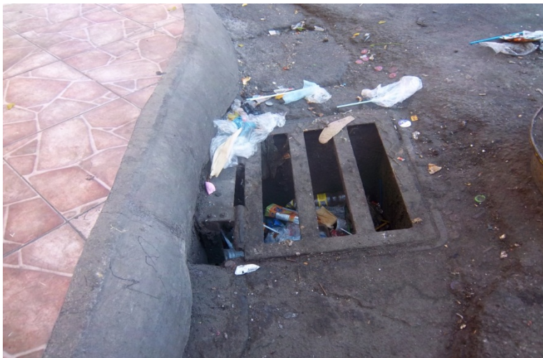
Alcantarías en Mal estado con basura en su interior. Ciudad Jardín
