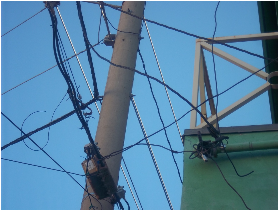
Conexión eléctrica en mal estado. Ciudad Jardín
