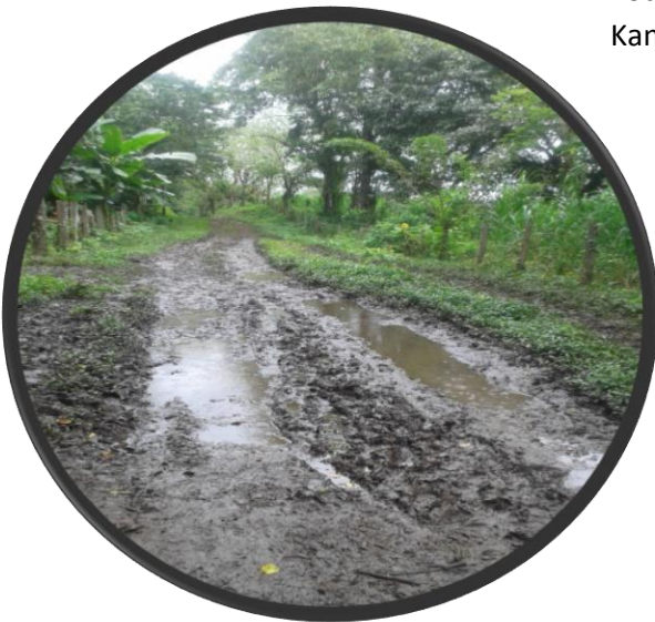
Fotografía 3 camino en mal estado Comunidad Granadillo 1
