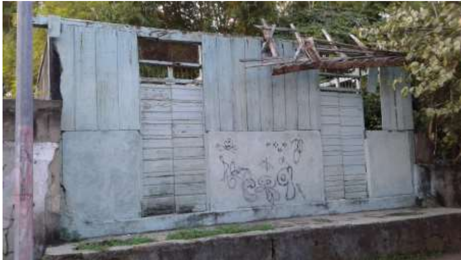
Casa construida de madera en total que se encuentra en muy mal estado
