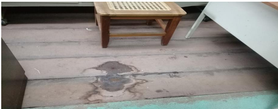
Ilustración No. 8 Tomada por Mariela Hernández. Fecha: 18/11/2020. Daño al piso de madera por filtración de agua fluvial. Sección de archivo Número 2.
