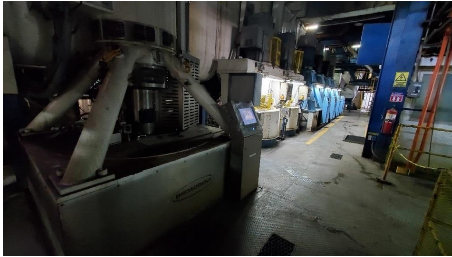
Figura 4. Fotografía zona Sur de Centrifugas Fuente: Propia
