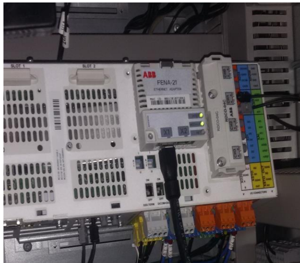
Figura 9. Imagen del módulo instalado en el VDF. Fuente: Propia.
