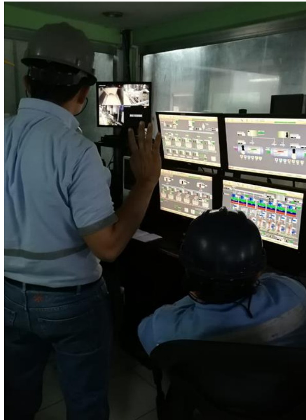
Figura 22. Ambiente del cuarto de control de las demás líneas centrifugas. Fuente: Propia
