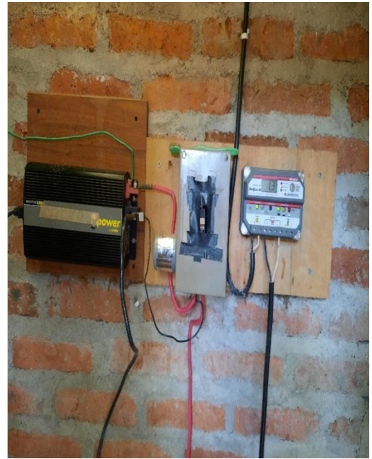
Foto. Partes del sistema solar fotovoltaico
