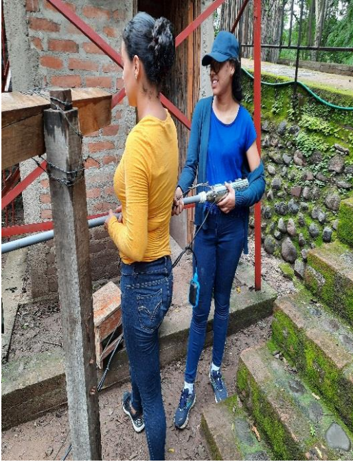
Foto. Conexión de la tubería a la bomba
