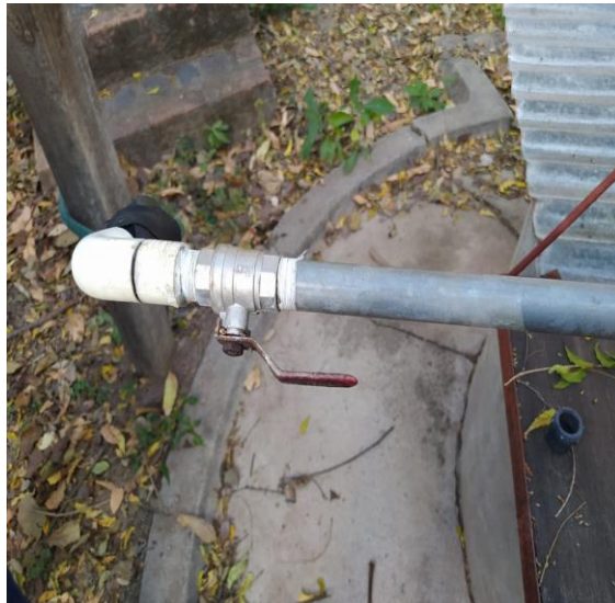
Figura 21: Tubería de descarga libre
