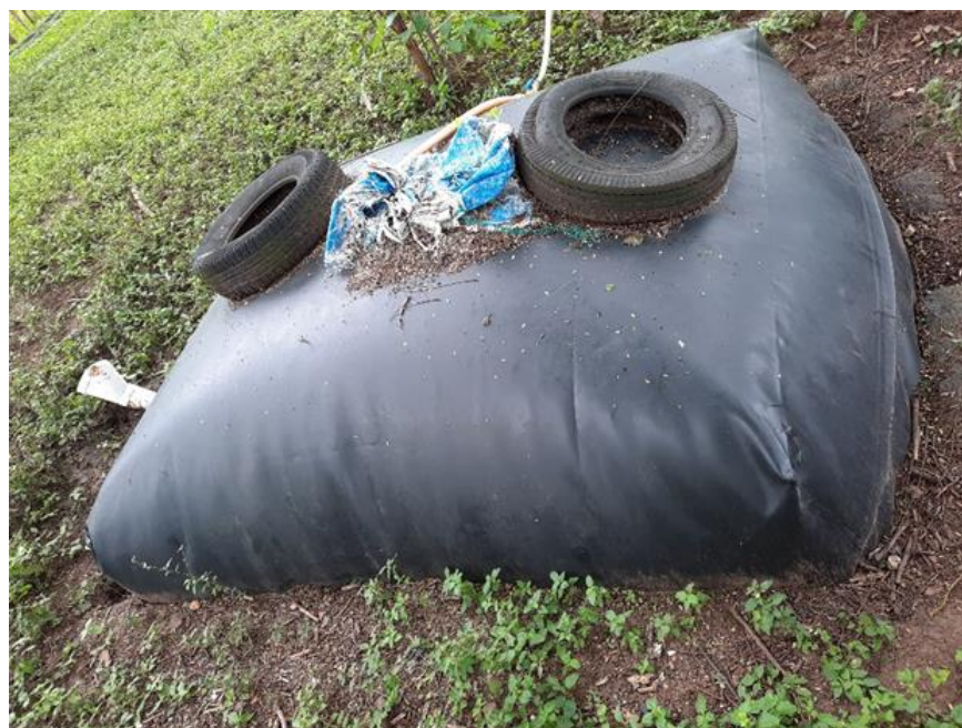
Foto. Biodigestor instalado en finca Jacaranda
