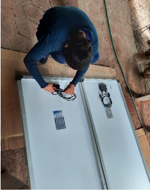
Foto. Conexión de paneles en serie
