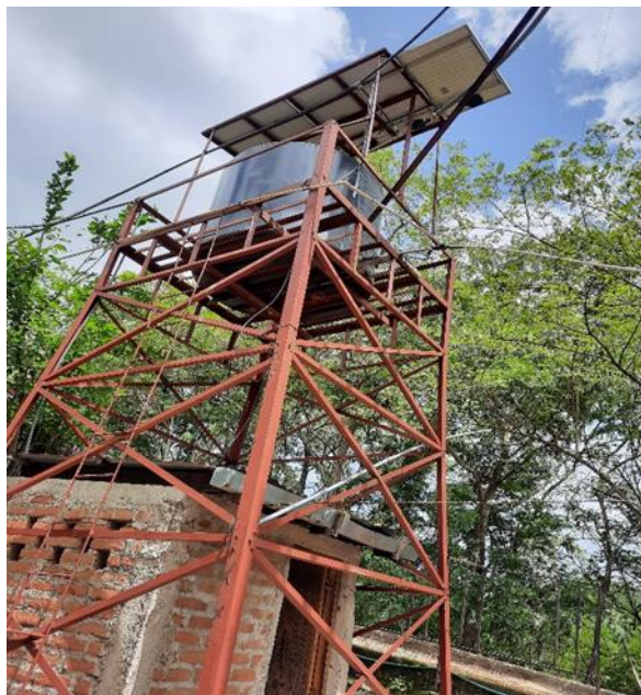
Figura 20: Sistema de almacenamiento de agua y fuente de gemación fotovoltaica
