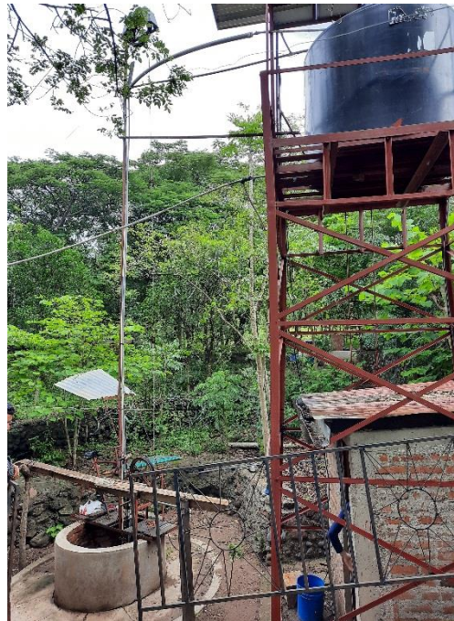
Foto. Sistema de bombeo Solar Fotovoltaico
