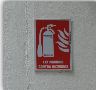
Imagen 12. Extinguidor contra incendios.
