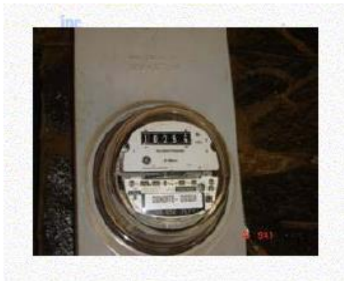
Figura 10. Medidor de energía con Ciclómetros
