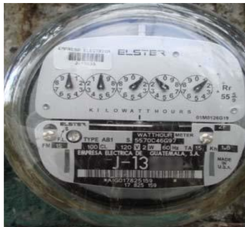
Figura 7: Medidor de energía por inducción
