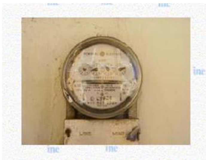
Figura 9. Medidor de energía con diales.
