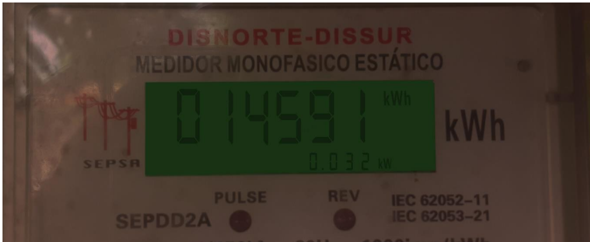
Figura 46. Lectura actual del medidor
