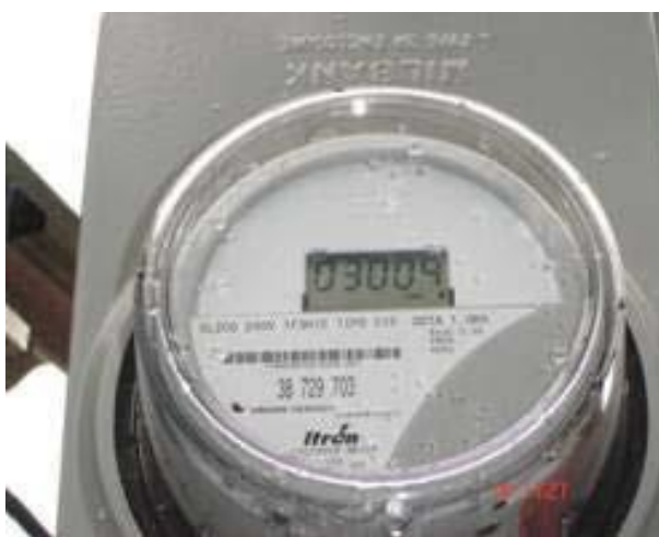
Figura 11. Medidor de energía con Display LCD
