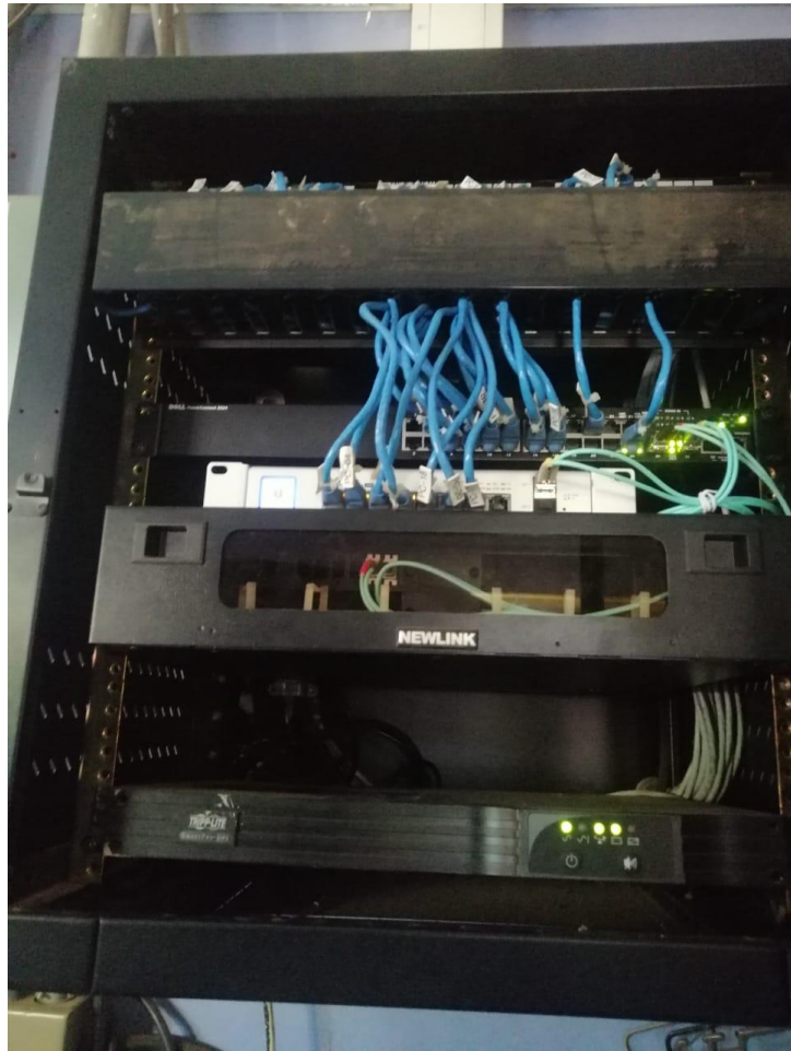
Ilustración 13 Equipo disponible, Switches.
