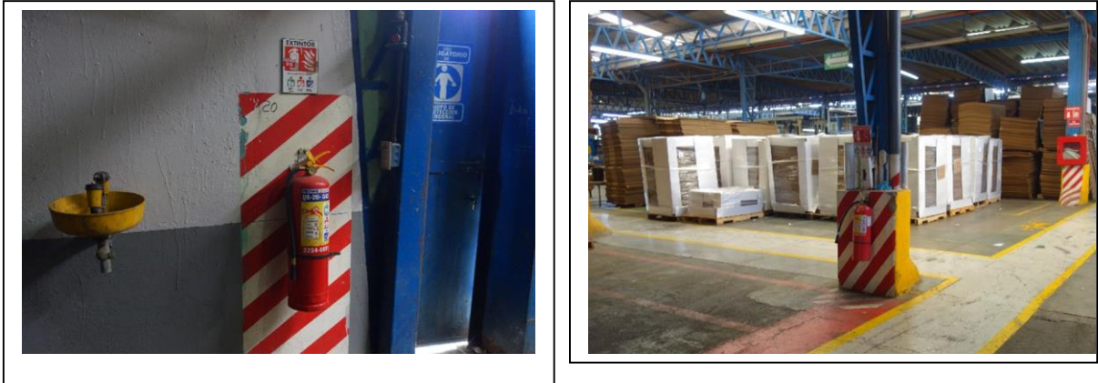
Figura 6: Disponibilidad de equipos de seguridad. Disposición de extintores en diferentes áreas de la empresa.
