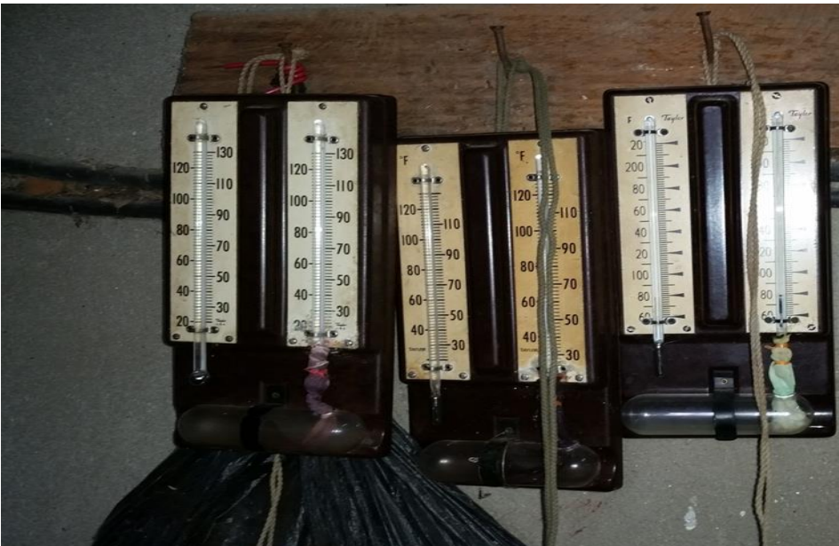
Imagen No. 16 Medidores de temperatura, sistema de secado kalfrisa. Fuente TAONIC S.A.
