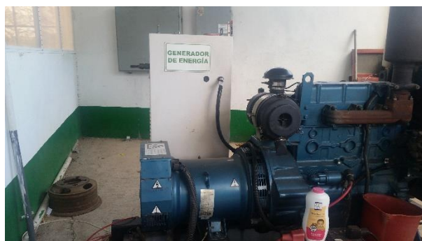
Figura 9 Generador de fluido eléctrico.
