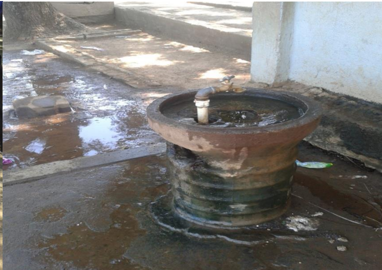
Foto 4. Bebedero en mal estado desperdicio de agua.
