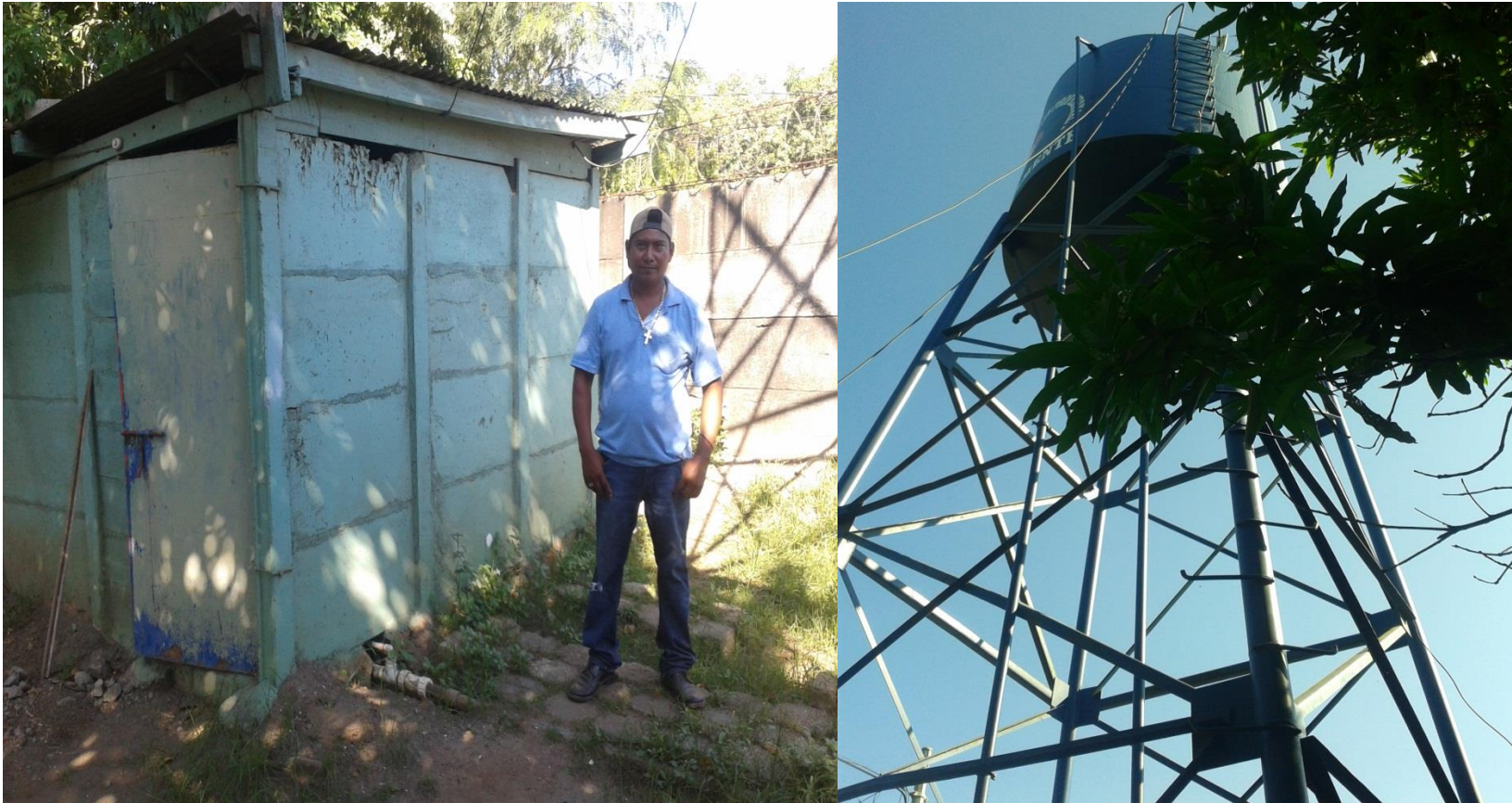
Foto: 15 y 16 cuarto de bobeo de agua (bombas iromatic) y tanque de agua.
