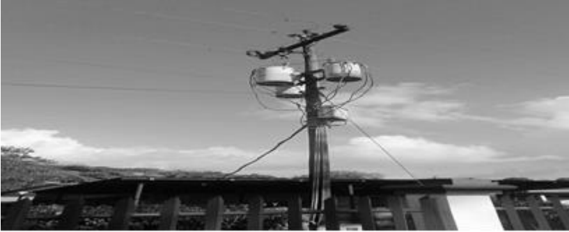
Foto 3: Vista del banco de Transformadores
