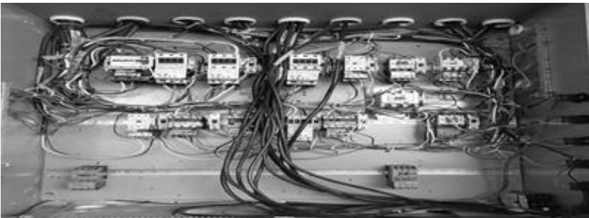
Foto 2: Control de mando de todos los Equipos de Potencia
