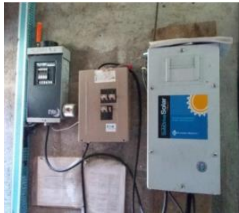
Figura 15. Sistema de bombeo solar
