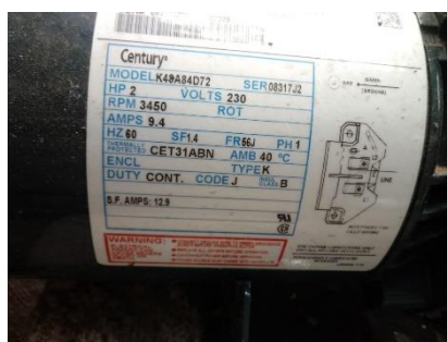
Figura 11. Bomba utilizada en el sistema de re bombeo.
