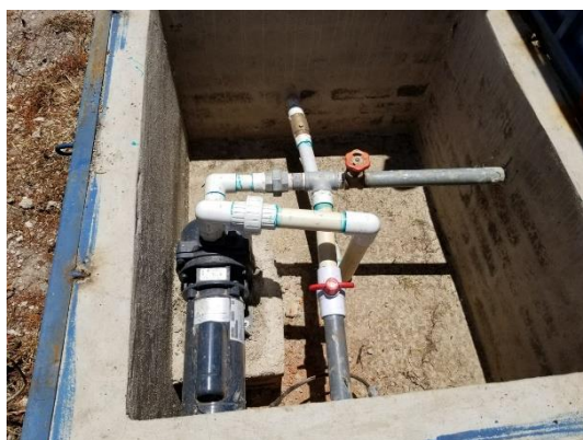
Figura 12. Sistema de re bombeo.
