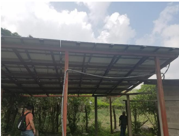
Figura 14. Arreglo solar fotovoltaico del sistema de bombeo.
