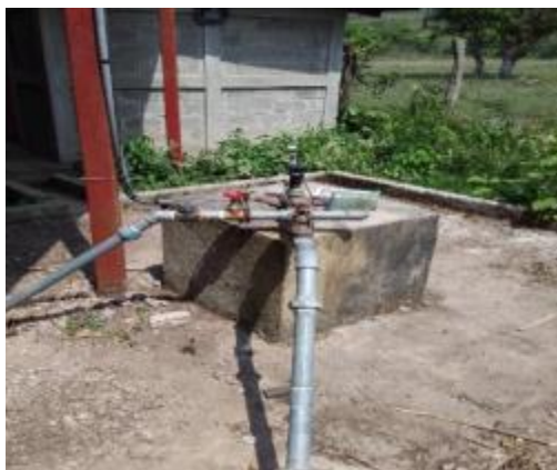
Figura 17. Sarta de bombeo.
