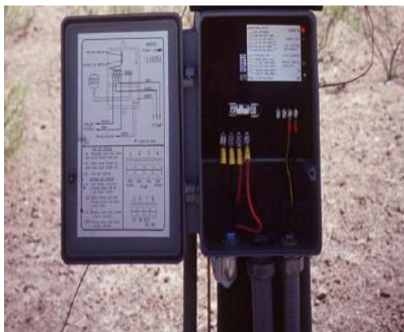
Figura 5. Regulador de carga de un sistema de bombeo.
