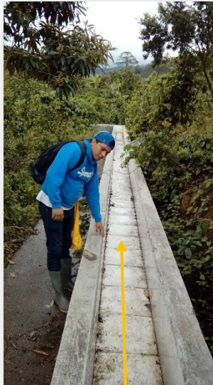
Foto No 6. Canal de Correteo Finca la Quinta. ( Fuente Propia)
