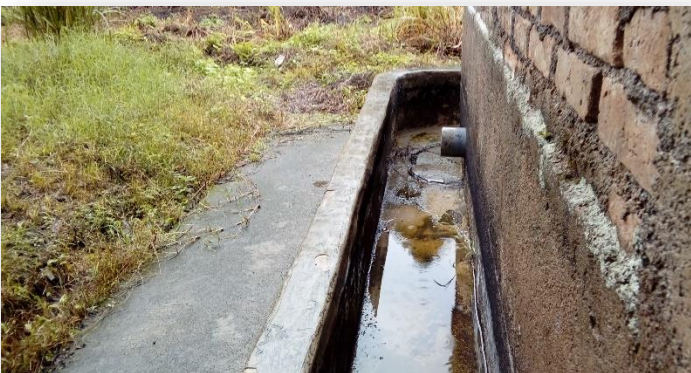
Foto No 15. Canal de Correteo comunidad el Janeiro.( Fuente Propia).
