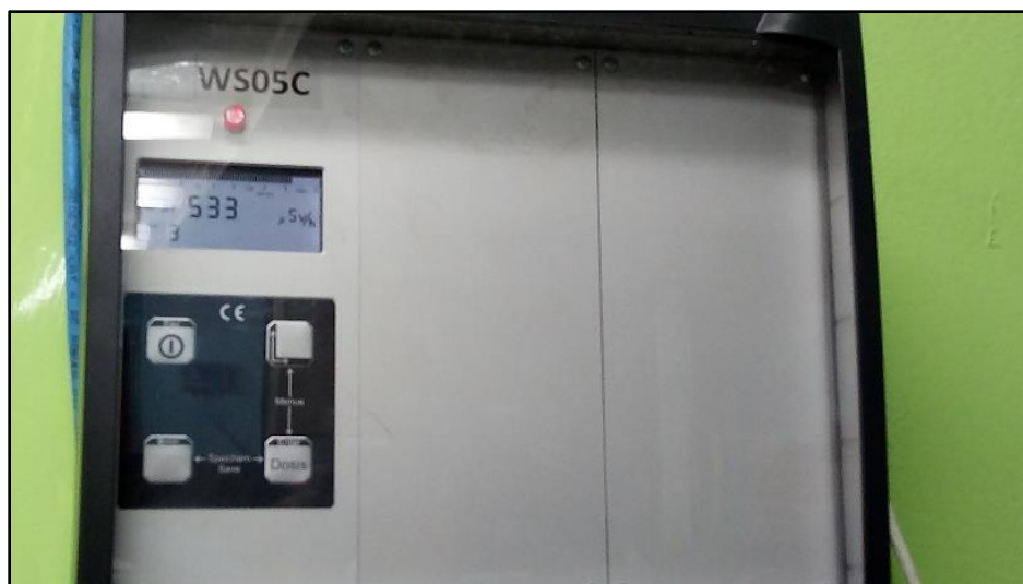
Figura 19. Monitor de radiación de sala de tratamiento.
