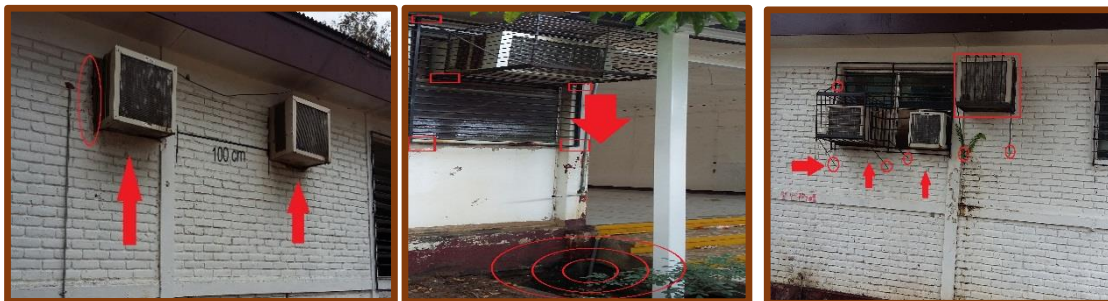
Figura 6-21. Enfriadores ubicados inadecuadamente.
