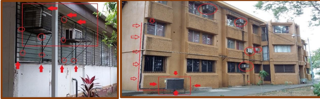
Figura 6-23. Enfriadores ubicados inadecuadamente.
