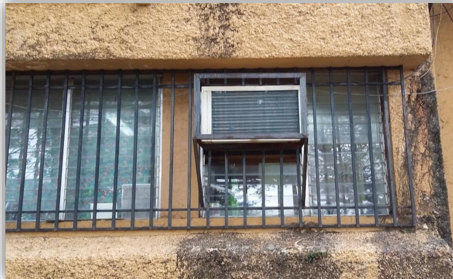
Anexo 33. Mala colocación de Aires acondicionados en una gran parte de los edificios.
