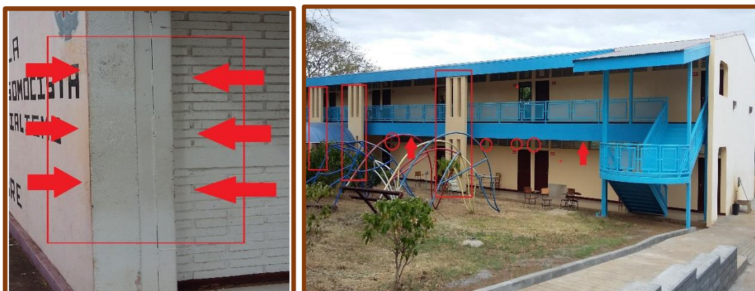
Figura 6-18. Uso inadecuado de rigideces con respecto a los materiales utilizados.
