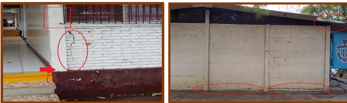
Figura 6-16. Daños por efectos de Sismos
