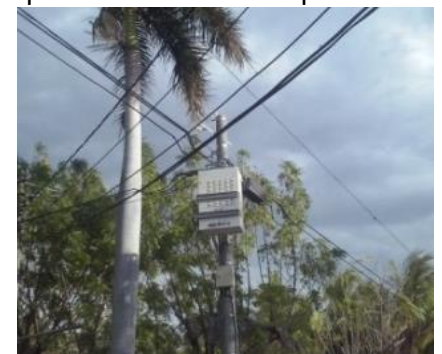
Imagen 98 / Transformadores / Fuente: Propia
