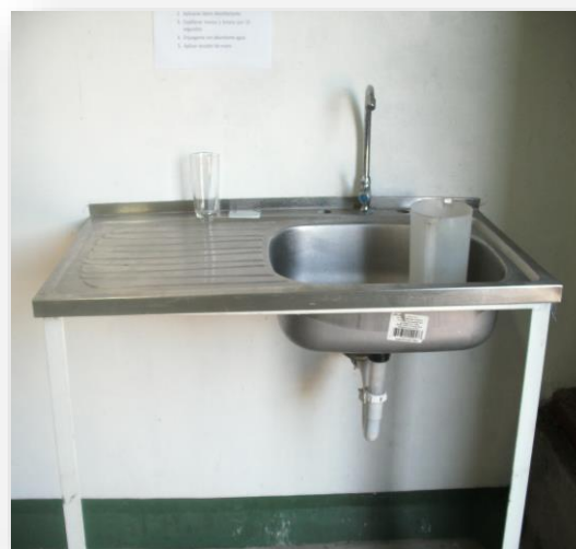
Imagen 16 Instalaciones para lavarse las manos Fuente: Manual de BPM de Ritter Sport
