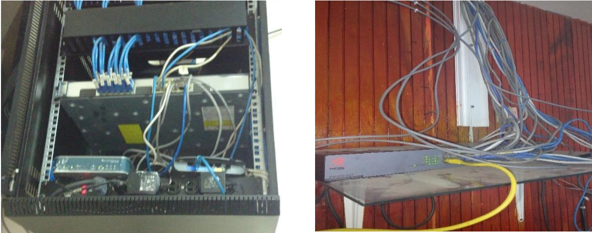
Figura 2. Cableado de red principal
