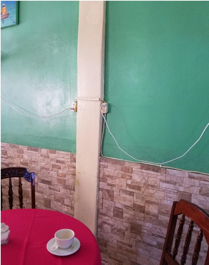
Anexo 19: toma corriente en el área de la cafetería
