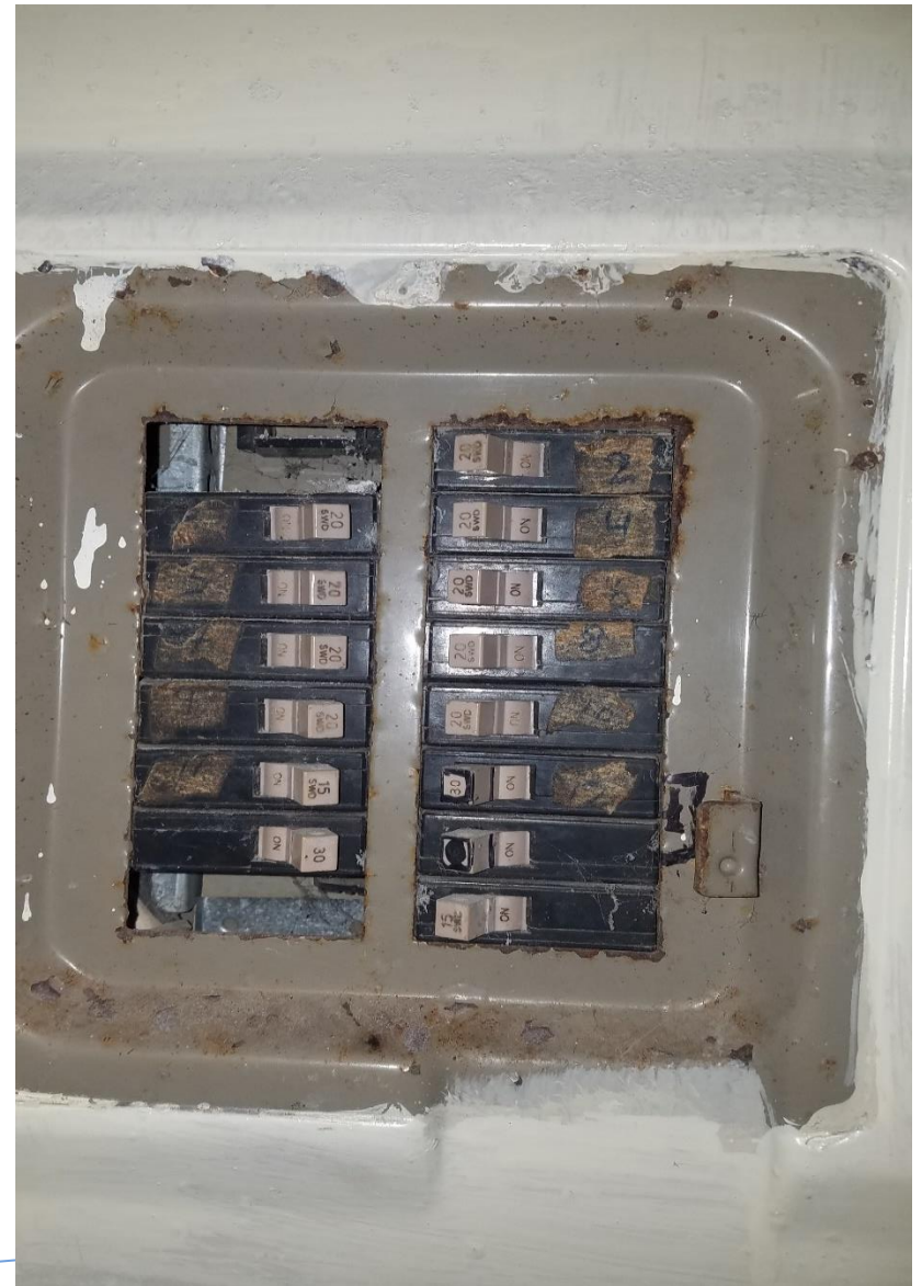
Anexo 18: estado de panel y disyuntores
