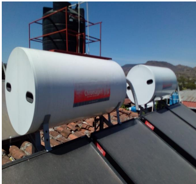
Fotografía 4. Sistema de colectores solares en el techo del Hotel Casa Vínculos
