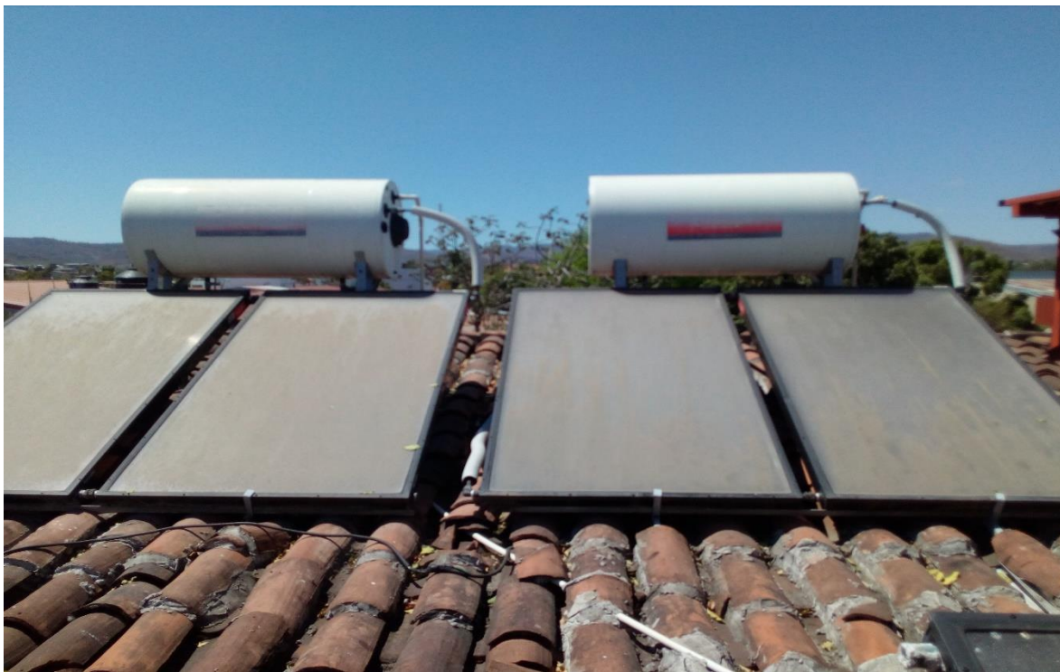
Fotografía 5. Sistema de colectores solares en el techo del Hotel Casa Vínculos
