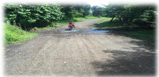
Imagen N° 7, Carretera afectada por la estación lluviosa. (Volcán Maderas)
