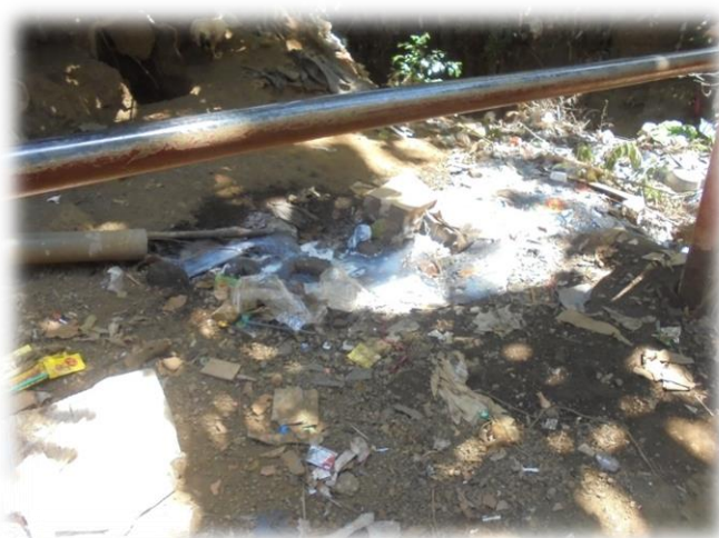
Ilustración 9. Terminal de las aguas sucias de la cuadra, desaguan en el cuse. Fuente: Propia.
