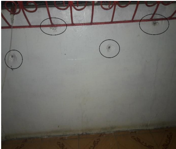
Foto 7: Orificios de balas en la vivienda de Edgard Sevilla que datan del año 1979. Fuente: Edgard Sevilla.
