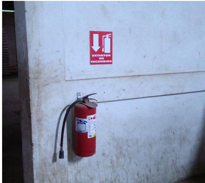
Imagen 3. Extintor (Fuente Propia)
