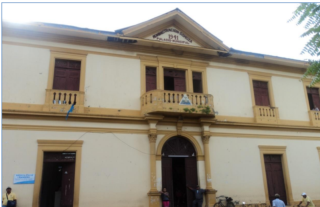
Aspecto del Palacio Municipal sin recibir ningún tipo de mantenimiento.
