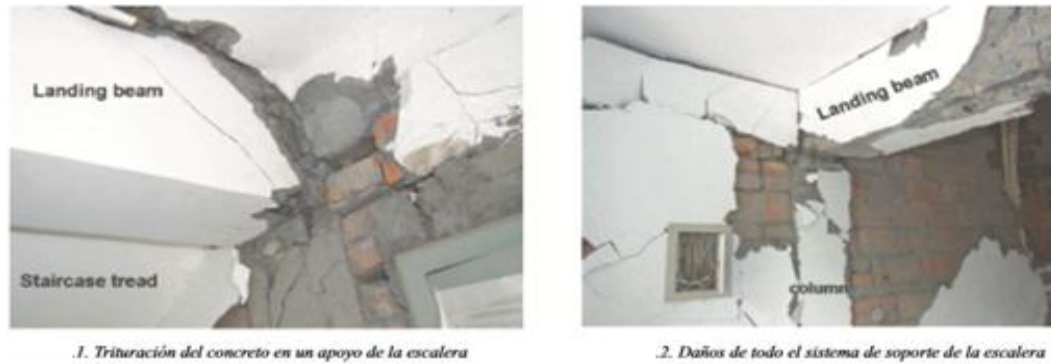
Figura N°31: Daños producidos por sismos.
