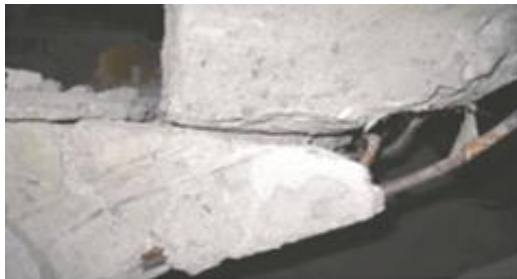
1. Daños por fuerzas cortantes en las escaleras
