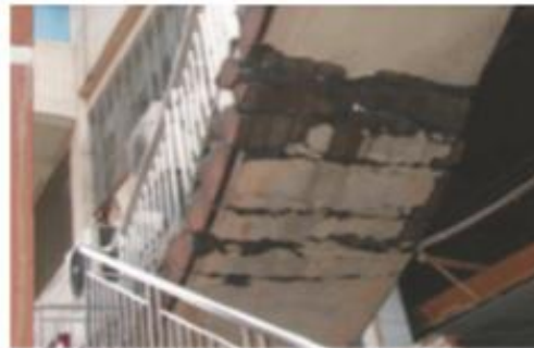
2. Daños en el soffito de la losa escalera
