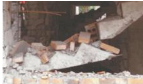
2. Separación total en los escalones
