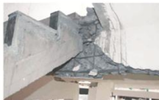
2. Daños por corte y deformación por flexión en la viga soporte
