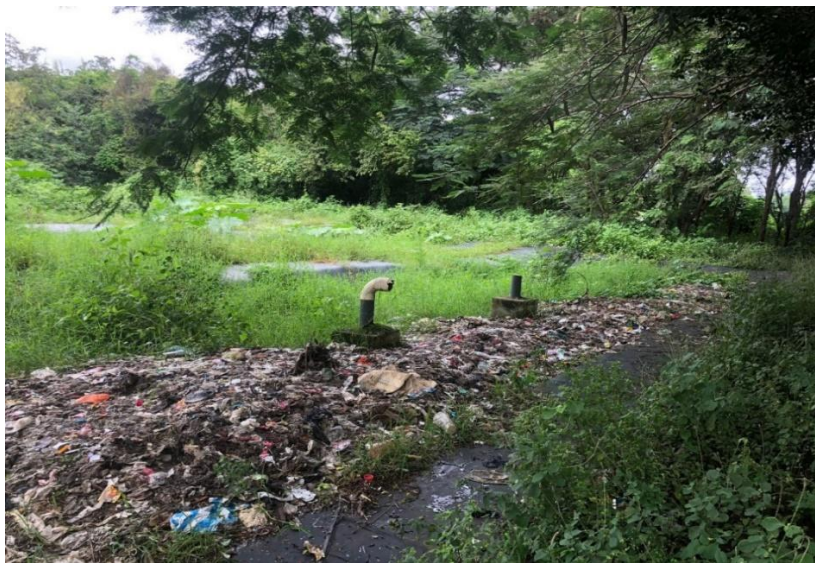
Depósito de desechos sólidos que son retirados de las rejillas que se encuentran en el canal de entrada del sistema de aguas residuales.
